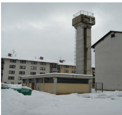
Slika 12: kotlovnica Knafļjev trg
