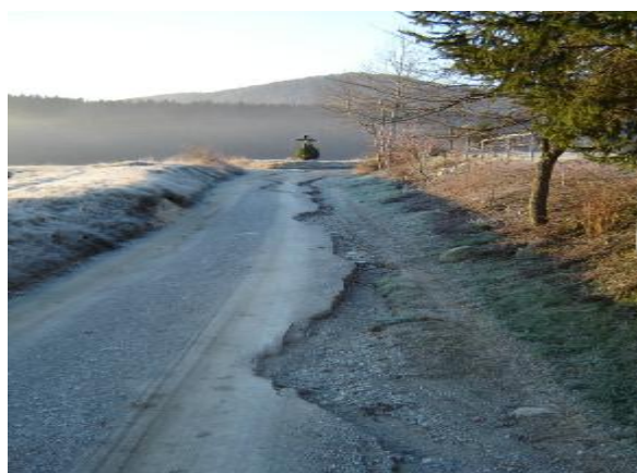
Slika 10: poškodba cestišča zaradi neurja
