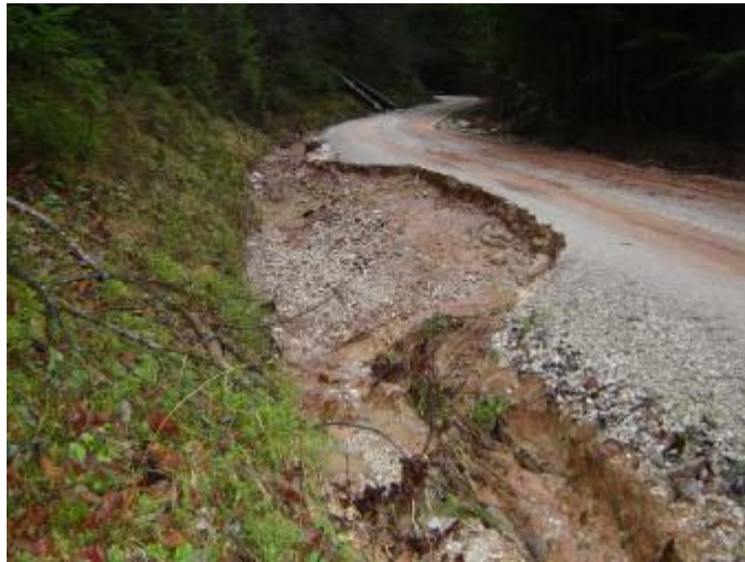
Slika 10: poškodba cestišča zaradi neurja
